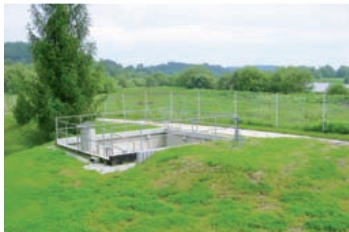
Obr. 3: Objekt bubnových filtrů
