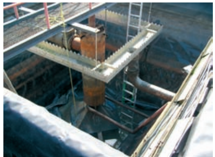
Obr. 5: Vypuštěná dosazovací nádrž
