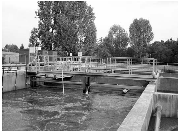
ČOV Vinoř – aktivace s dobře viditelnou normou stěnou a lištou pro stírání pěny z hladiny
