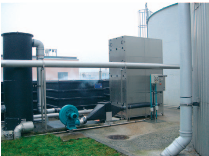
Luxemburg - filtry s foto-katalytickou oxidací a předřazenou pračkou vzduchu plně nahrazují vyřazené biologické filtry v pozadí
