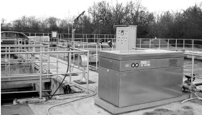
Celkový pohled na rekonstruovanou linku ČOV Jesenice
