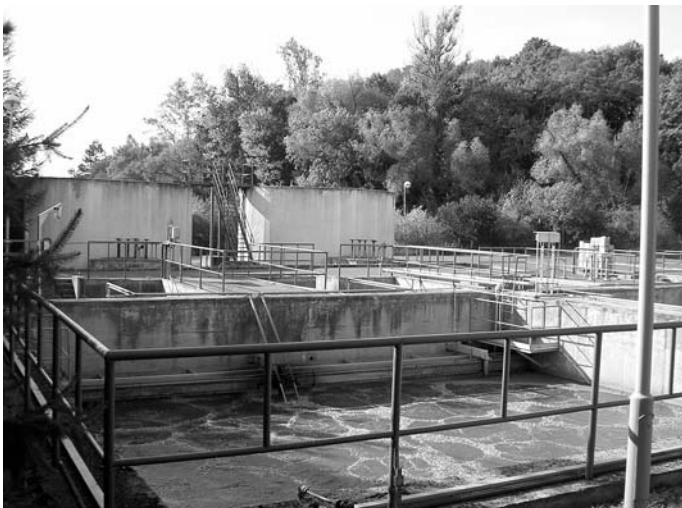
ČOV Dolní Chabry – aktivace se zařízením pro stírání hladiny
