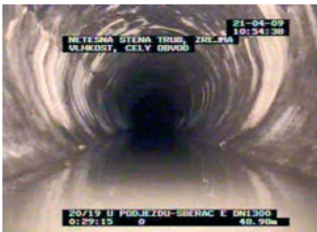
Obr. 3: Stav hlavního sběrače E před opravou
