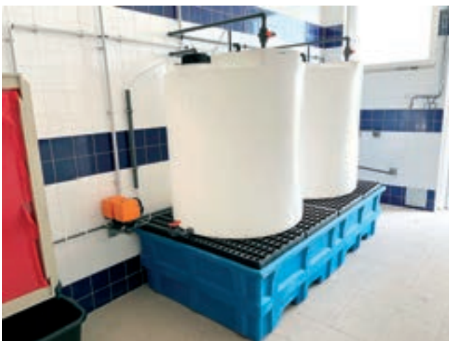
Hygienické zabezpečení – dávkování chlornanu sodného
