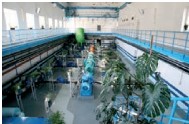
Úpravna vody Rečkov, strojovna čerpací stanice
