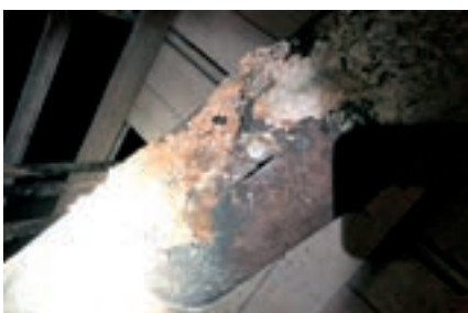
Porucha potrubí VN 3
