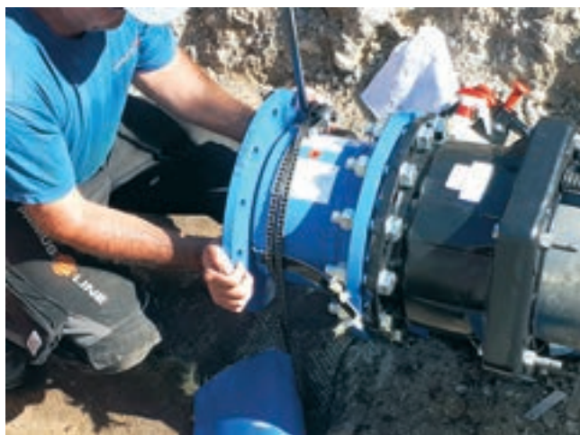
Po montáži patentovaných přírubových spojek, tlakové zkoušky a dezinfekci lze uvést sanovaný úsek zpět do provozu
