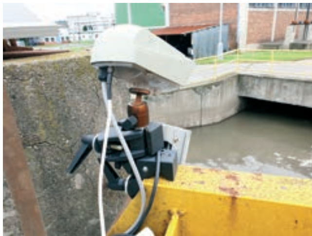
Obr. 2: Kamery jsou osazeny na přítocích na obě vodní linky ÚČOV
