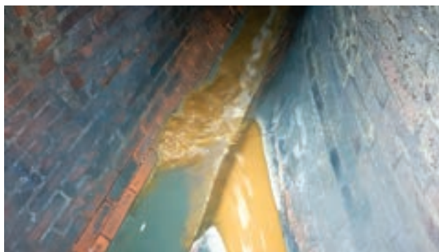
Obr. 5: Začátek výskytu odpadních vod se změněnou barvou
