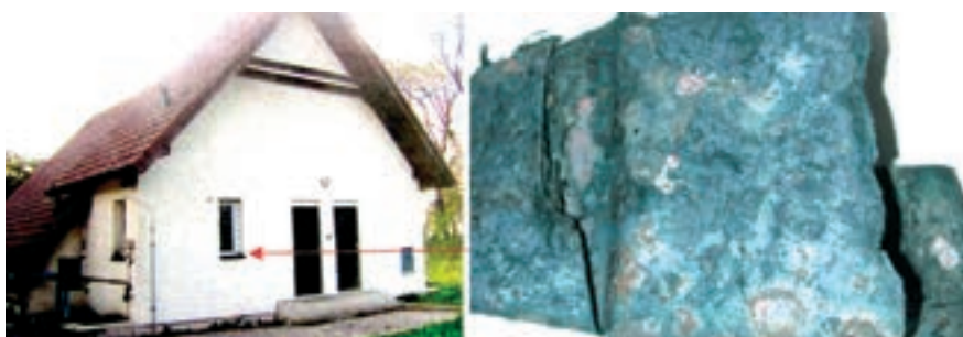
Obr. 6: Příklady korozního napadení měděných prvků na objektu ČOV
