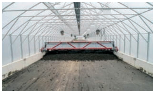
Obr. 5: Pohled do solární sušárny Mariánské Lázně se zařízením WendeWolf
