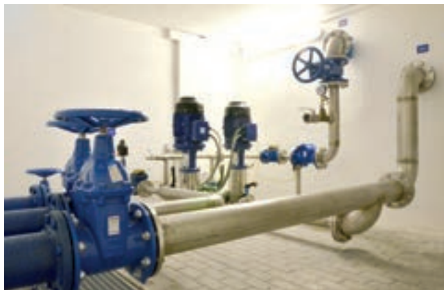
Čerpací stanice Pod Vyhliškou, Náchod
