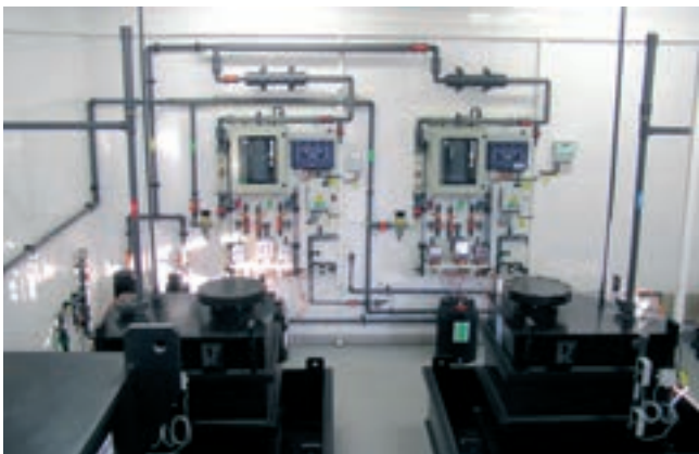
Chlordioxidová stanice u ČS Vysoká Srbská
