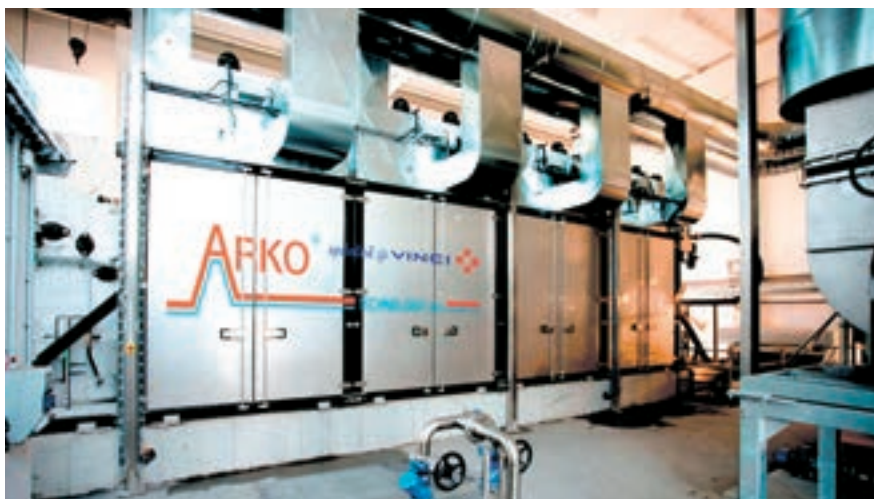
Obr. 6: Nízkoteplotní sušárna Pro-Dry M 2/4 LT (SÜLZLE KLEIN) na ČOV Přerov
