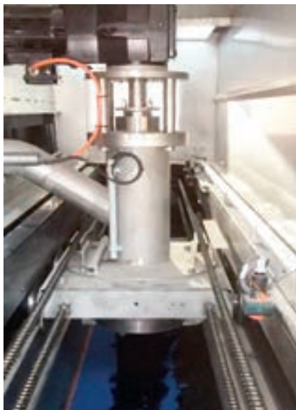
Obr. 4: Distributor odvodněného kalu s řezačím nožem na sušicí pás („nudličkovač“)
