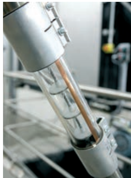
Obr. 5: Diskový trubkový dopravník granulovaného sušeného kalu do kontejnerů
