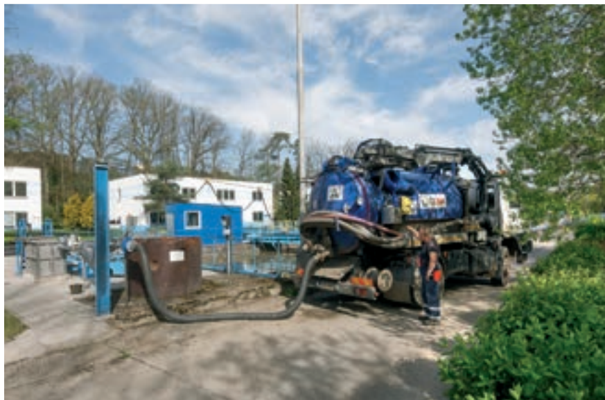
Areálová čistírna odpadních vod Tábor
