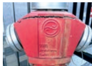
Roztržená hlava hydrantu díky zmrznutí vody v hydrantu
