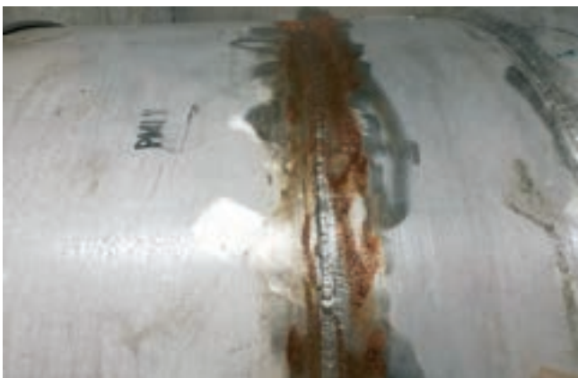
Obr. 10: Koroze „nerezového“ potrubí v místě svaru
