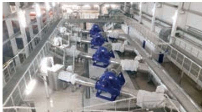
Obr. 15: Nová čerpadla na GAU v provozní čerpací stanici
