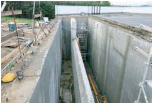
Obr. 7: Vestavba dělicí stěny do původního obtokového kanálu a jeho rozdělení na obtokový žlab a spojnou komoru
