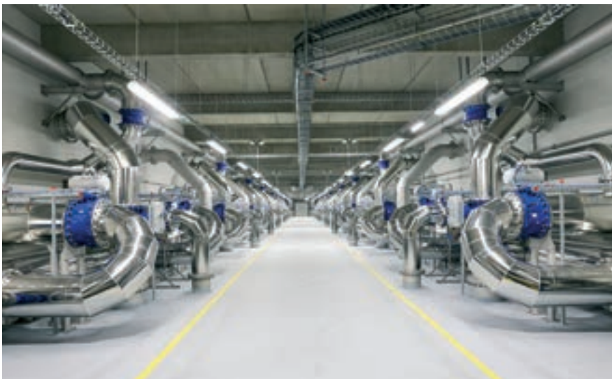
Obr. 4: Chodba mezi filracemi s povrchovou úpravou prvků z nerezové oceli s maximální drsností Ra 0,5 μm
