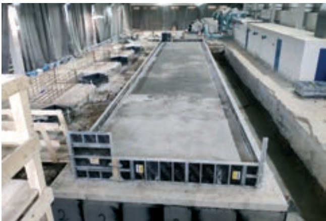
Obr. 8: Provozní čerpací stanice – nový betonový blok pro horizontální čerpadla vč. úložné vany
