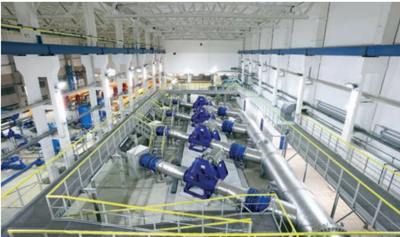
Obr. 3: Čerpání na GAU – Q = 1\,200\text{ l/s} , H = 18\text{ m} (4 ks) umístěné ve stávající provozní čerpací stanici
