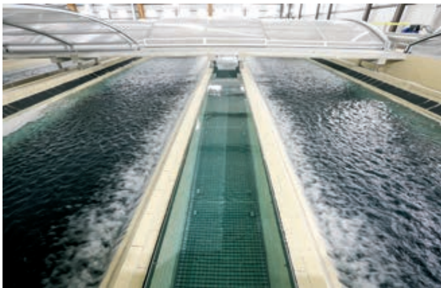
Obr. 1: Pohled do filtrů s GAU
