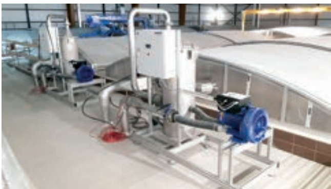
Obr. 4: Dvojice destruktorů pro odstranění ozonu ze vzduchu odvětrávaného z prostoru pod zakrytím filtrů
