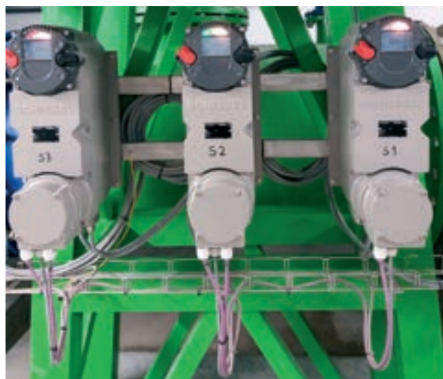
Obr. 4: Smartcon – řídicí jednotka inteligentního pohonu Schiebel na nátoku surové vody do ÚV
