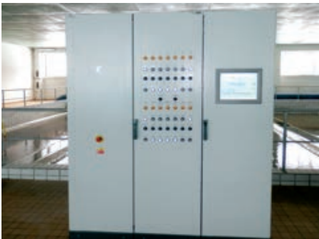
Obr. 1, 1a: Rozvaděč ovládání armatur filtrů
