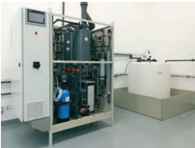
Obr. 6: Elektrochlorace na ÚV Březová
