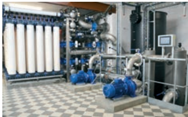
Obr. 3: Ultrafiltrační jednotka na ÚV Svobodka
