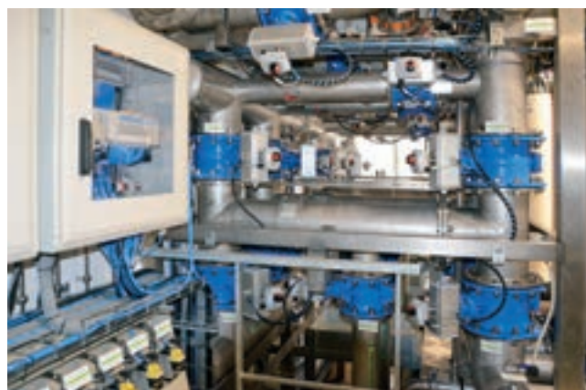
Obr. 4: Detail ultrafiltrační jednotky na ÚV Svobodka (pneumatický řídicí systém a trubní rozvody)
