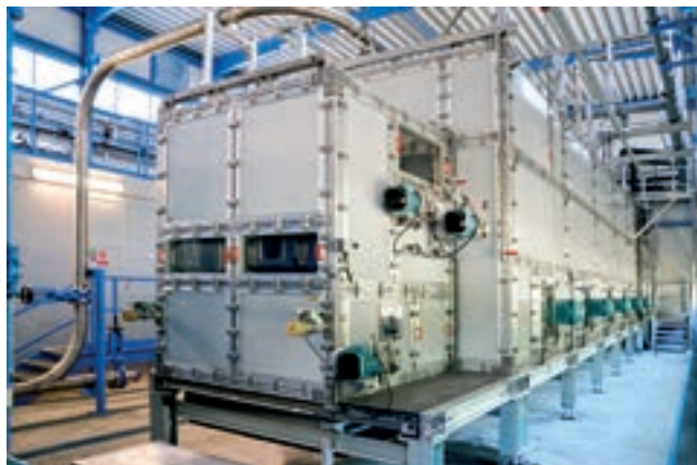
Obr. 8: Nízkoteplotní sušárna kalů na ČOV Drahotice
