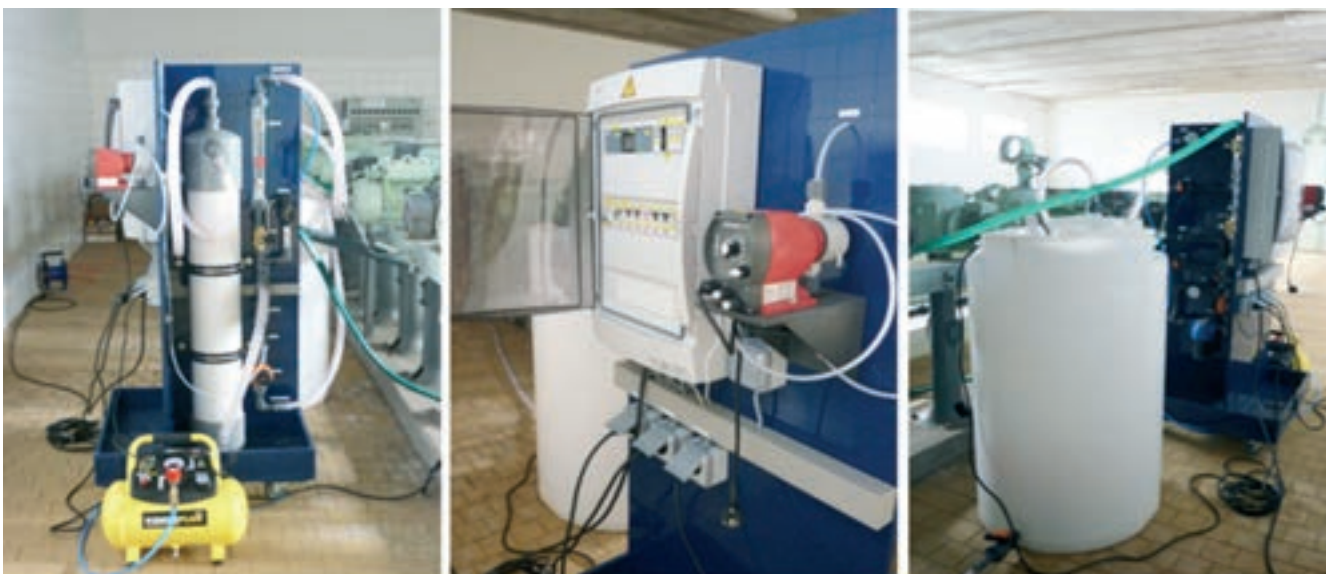
Obr. 2: Pohľad na ultrafiltračné zariadenie, samotný membránový modul, riadiacu jednotku a zásobnú nádrž na upravenú vodu
