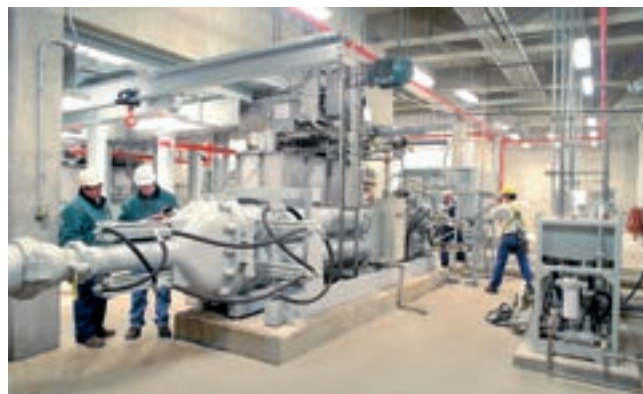
Čerpadlo SCHWING KSP na ČOV Blue Plains, Washington, D.C. (USA)
