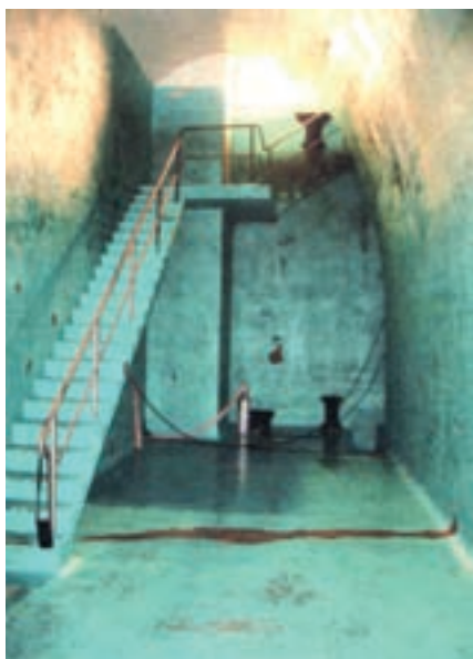
Obr. 5: Před rekonstrukcí vykazovala nádrž trhliny v podlaze z dusaného betonu, navíc byl potah z chlorkaučuku rozrušen a omítka hydrolyzou změkklá
