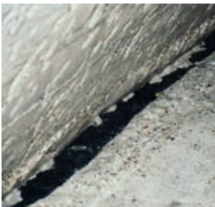
Obr. 1: Poklesy základové desky ukazují slabé místo konstrukce: spára mezi šikmou stěnou a základovou deskou zakouší nejvyšší zatížení vodou v nejslabším bodě
