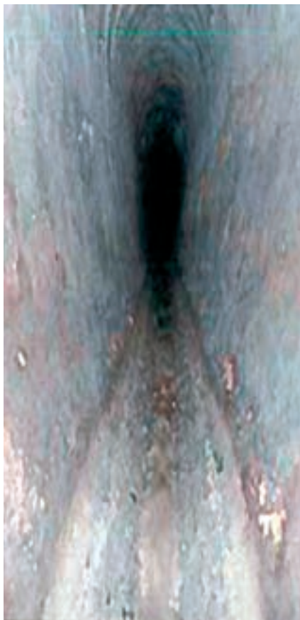
Betonová stoka v ulici Koněvova v Praze 3 před sanací...
