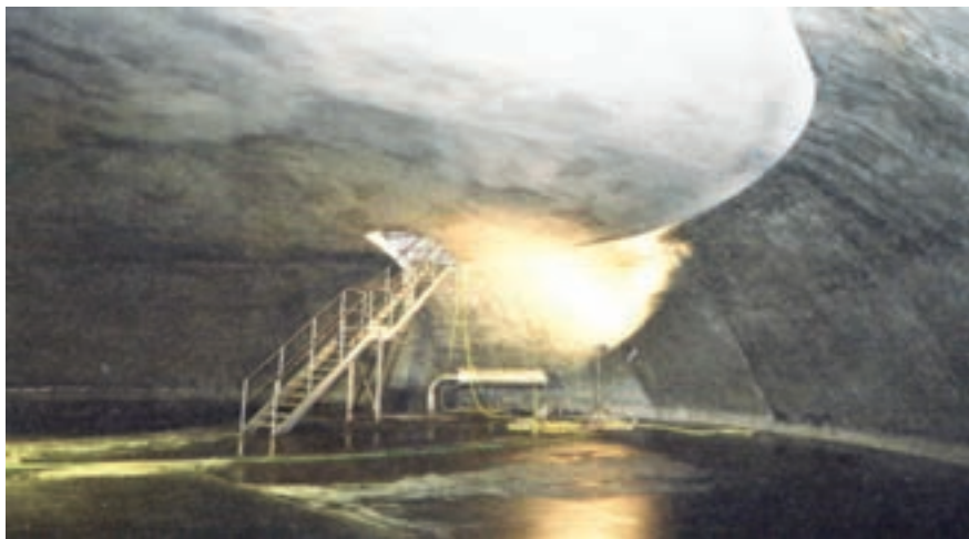
Obr. 2: Výsledný stav vodojemu po rekonstrukci s hrubě nastříkaným stropem, s hladkým povrchem stěn a dna bez pórů, bublin, dutin a kazů
