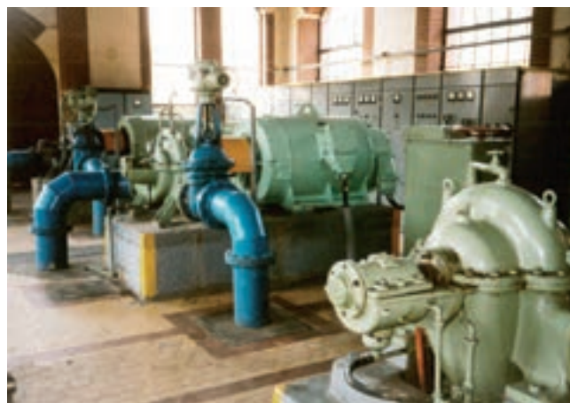
Obr. 12: Čerpadla do vodovodní sítě ze 70. let ve strojovně (foto 1995)
