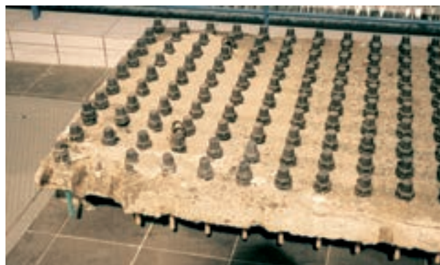
Obr. 1: Poškozená betonová mezidna (ÚV Plzeň)
