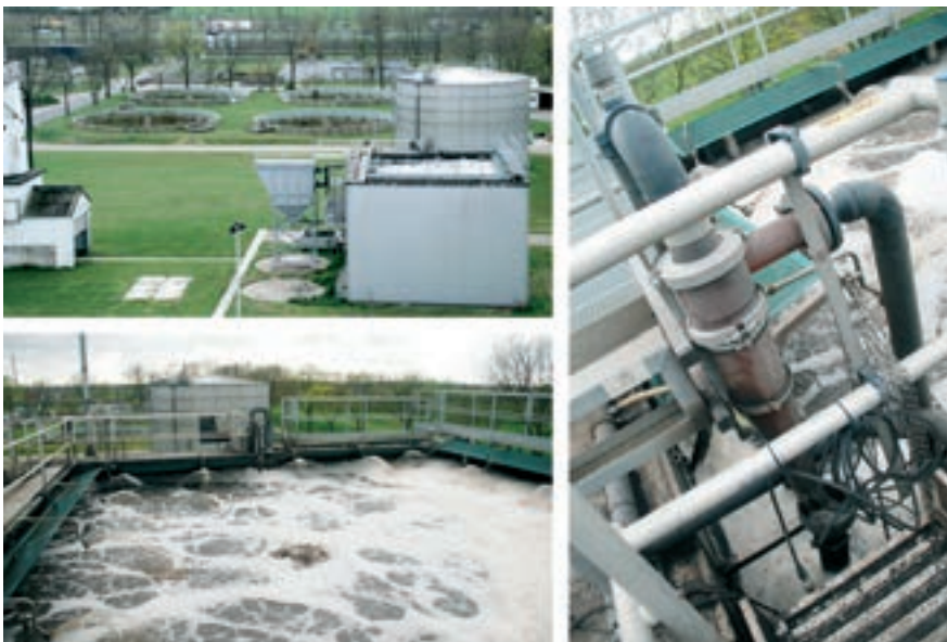
Obr. 7: Kontinuální DEMON v Breda (Nizozemí): reaktor a usazovací nádrž vybavená lamelami (vlevo nahoře), postřik hladiny vyčištěnou odpadní vodou (vlevo dole), hydrocyklon co odtaňuje z nádrže vločkovitý kal a zadržuje v systému anammox granule (vpravo)
