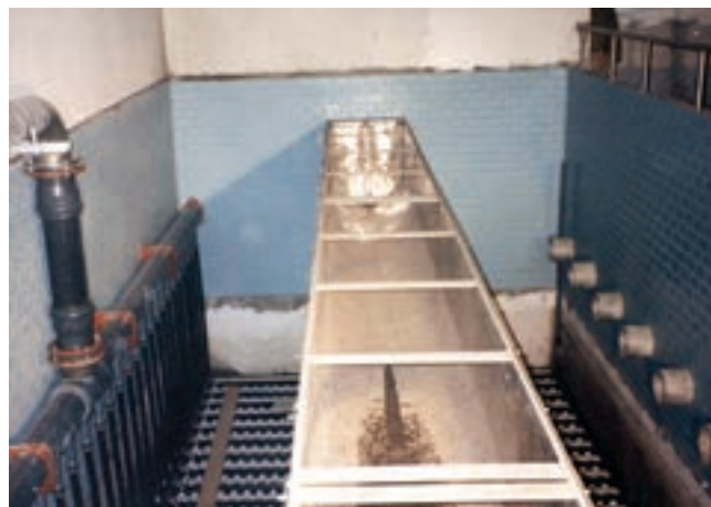
Obr. 2: Drenážní systém Aquafilter (ÚV Meziboří)
