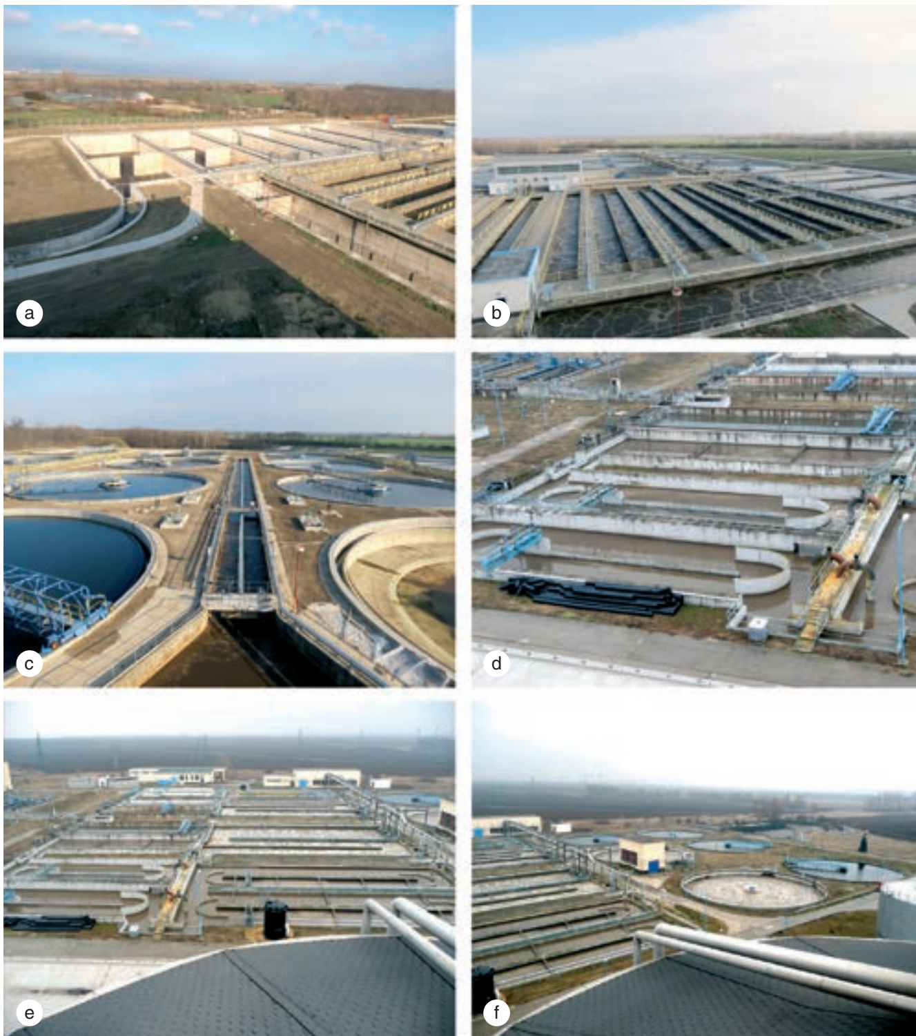
Obr. 2: a) ČOV BA, výstavba anaeróbných a denitrifikačných nádrží; b) ČOV BA, nitrifikačné nádrže v prevádzke, napravo anaeróbia a denitrifikácia v prevádzke; c) ČOV BA, kruhové dosadzovacie nádrže, v strede žlab s regeneráciou vratného kalu; d) ČOV TT, anaeróbné nádrže v prevádzke; e) ČOV TT, anaeróbné a denitrifikačné nádrže (obehové nádrže), vzadu prevzdušňované nitrifikačné nádrže; f) ČOV TT, 4 kruhové dosadzovacie nádrže, piata prevzdušňovaná nádrž je regeneračná nádrž vratného kalu
