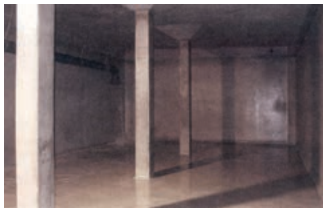
Obr. 2: Z důvodu stále nově vznikajících poškození vnitřních povrchů vodojemu byl v roce 1992 nanesen na stěny a opěry cementový nátěr
