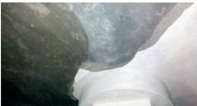
Obr. 8: Odpadnutí sanačního souvrství ze stropní konstrukce
